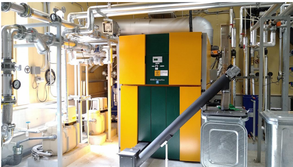
バイオマスボイラー
