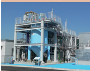
リン回収設備
