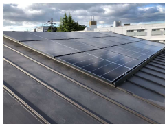
家庭向け共同購入事業により設置した太陽光パネル
