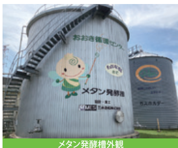
メタン発酵槽外観
