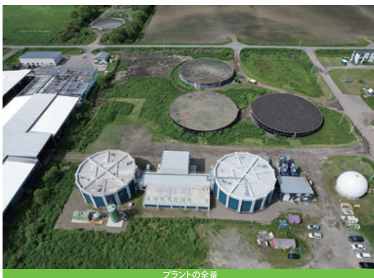
プラントの全景
