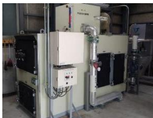
施設内 薪ボイラー
