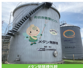
メタン発酵槽外観
