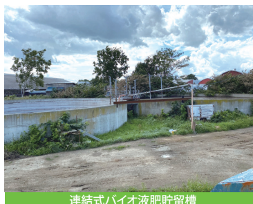
連結式バイオ液肥貯留槽
