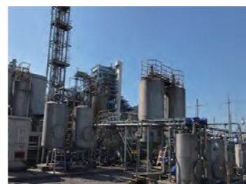
バイオエタノールプラント
