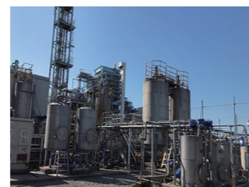
バイオエタノールプラント
