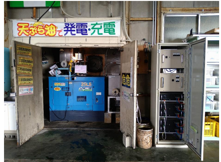
発電機と蓄電池
