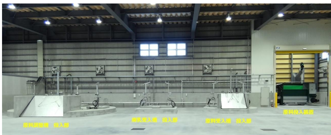
③嫌気性発酵処理施設棟 原料受入室 2
