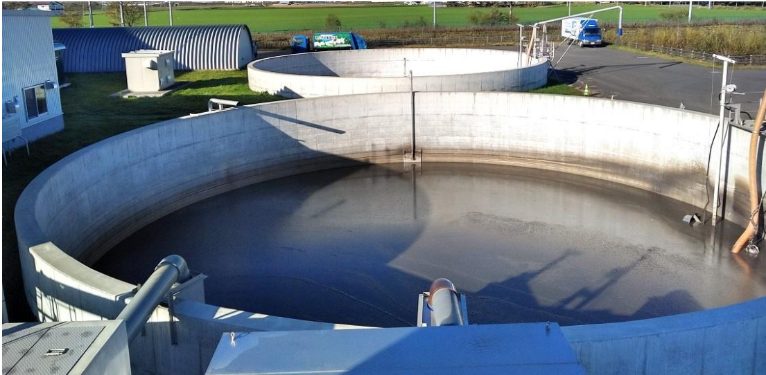
⑧消化液(液肥)貯留槽
