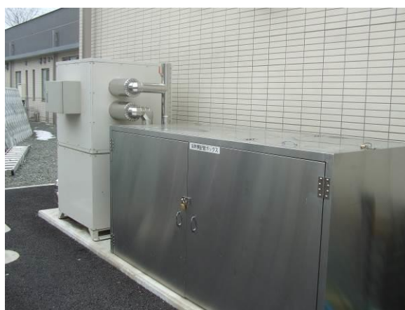
地中熱ヒートポンプ
