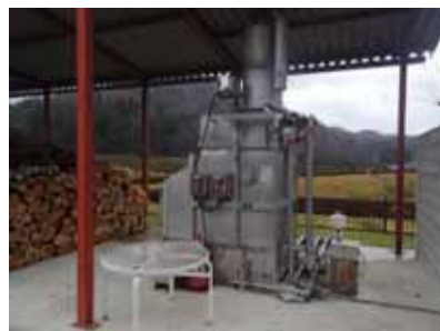
グリーンランドみずほの薪ボイラ
