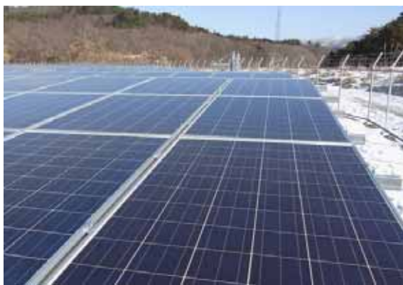
写真① 一関市東山太陽光発電所
