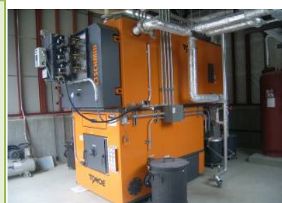
木質バイオマスボイラ
