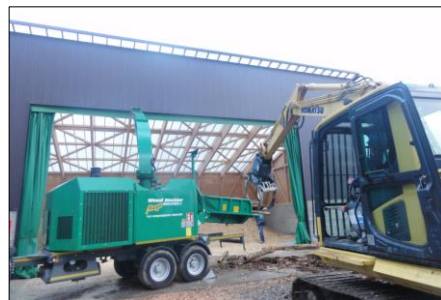
写真 2.3.3 木質チップ燃料製造施設
