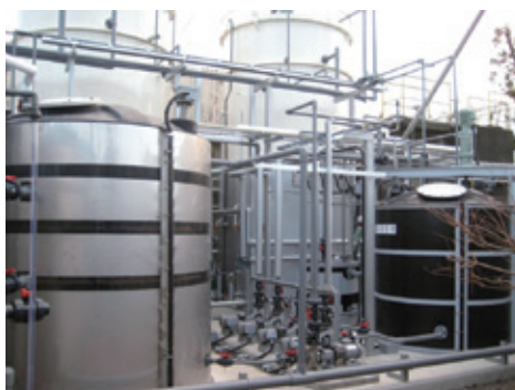
プラント外観
