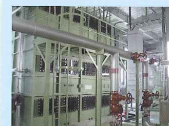
生物脱臭装置
