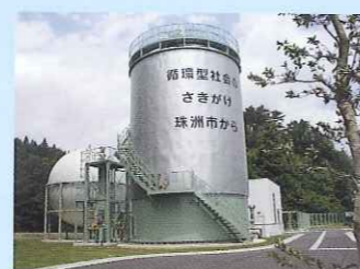
メタン発酵槽
