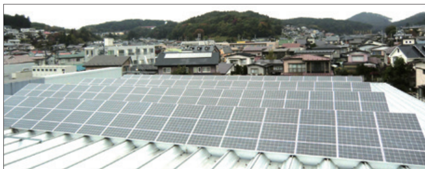
ベルフ山岸店 49kw 太陽光発電
