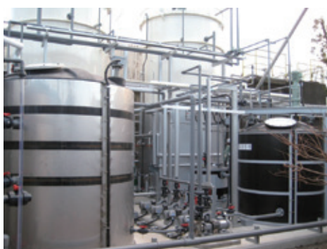
プラント外観
