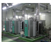
①混焼ボイラー
