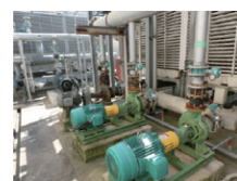
④冷却水ポンプ
