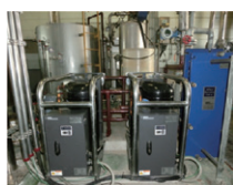
②ヒートポンプ&プレート
