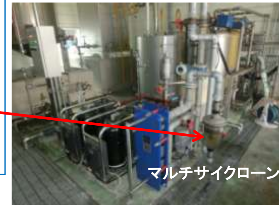
ヒートポンプ
