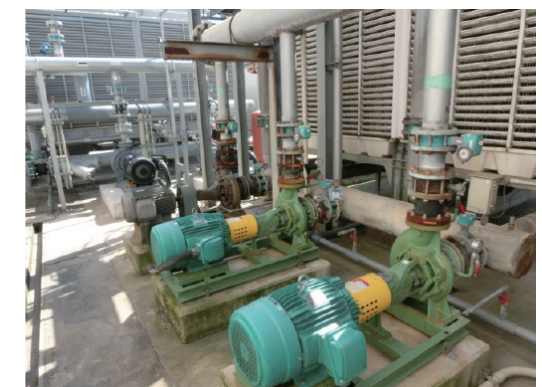
⑤冷却水ポンプ
