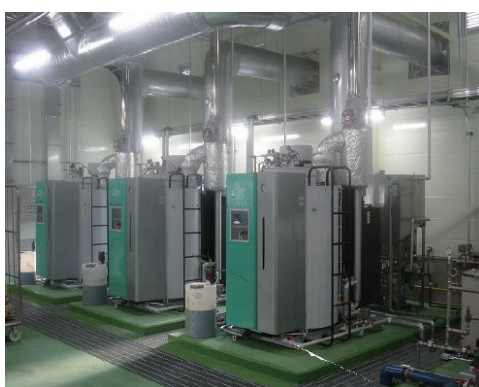
①混焼ボイラー
