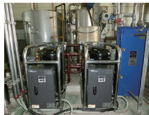
②ヒートポンプ&プレート
