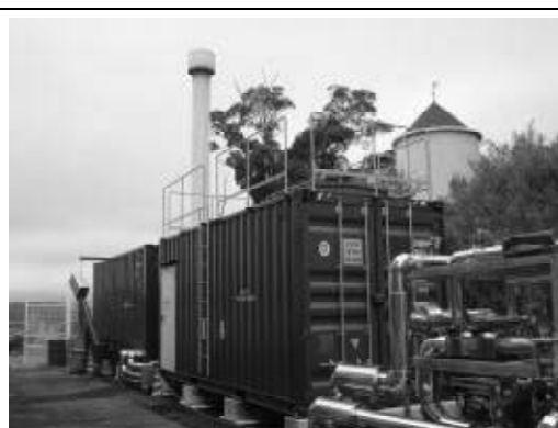
かどかわ温泉 心の杜 (木質ペレットボイラー 500kW/時)
