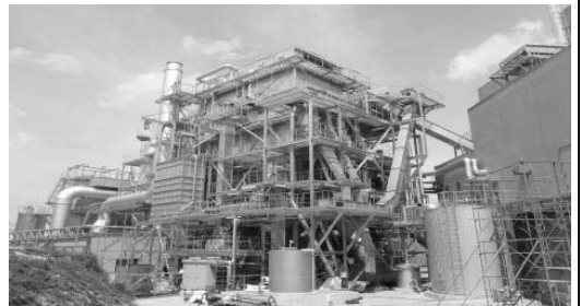
畜ふんボイラー : 南国興産(株) (2号機)
