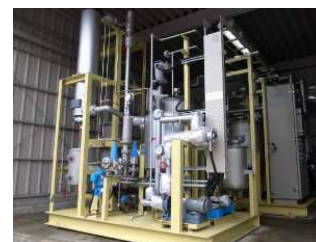
BDF製造設備（洲本市）
