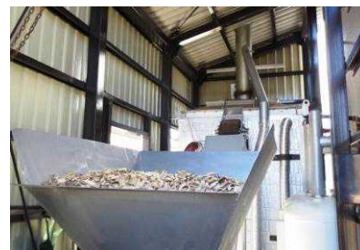
竹チップボイラー（淡路市）
