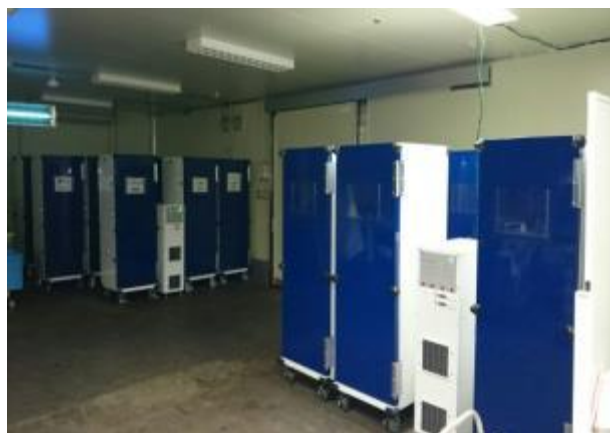
設置状況(プロセスセンター加工室内)
