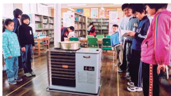
小学校に設置したペレットストーブ
